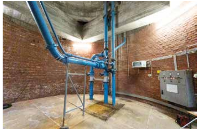
Erdgeschoss des Wasserturms. Zu-, Überlauf- und Ablaufleitung sowie die Tragwerkskonstruktion des Wassertanks sind beeindruckend. Rechts die elektrische Steuerung, links daneben die »Antennensteuerung« des Feuerwehrfunks des Kreises Dürren, so in Betrieb bis 2022.
